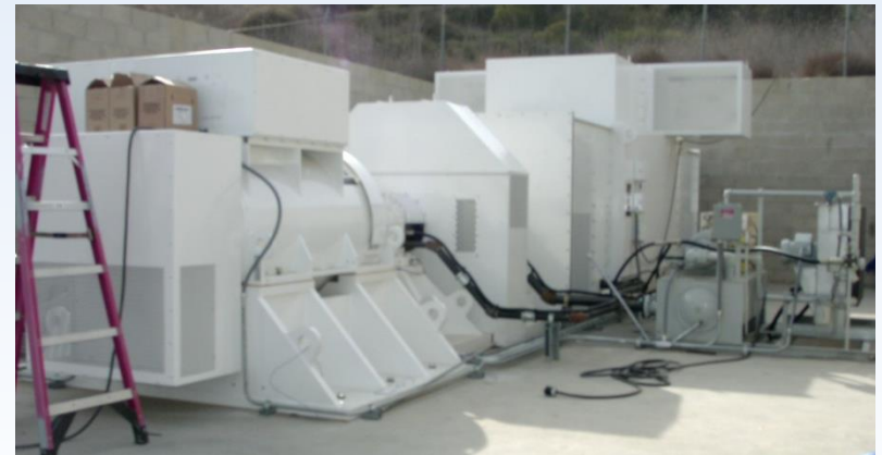
Kato COTS Generator
